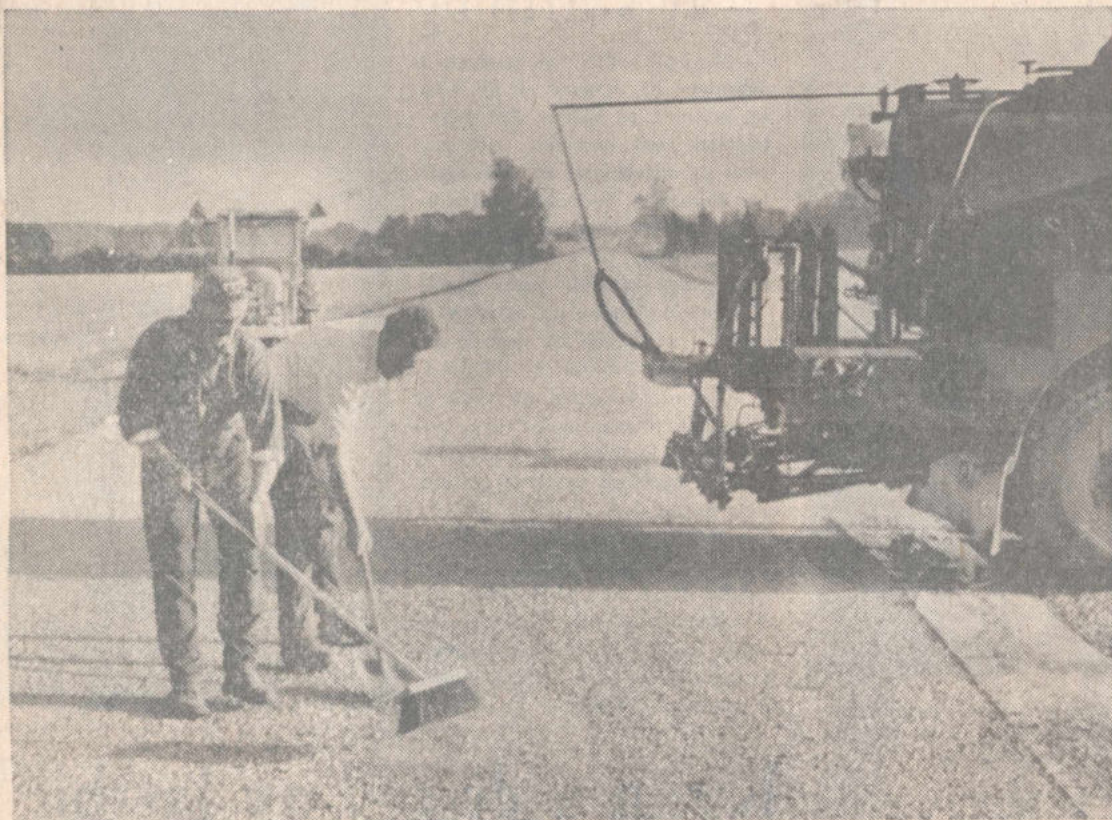
Raksträckor finns det gott om på den nya vägen, en följd av att denna följer järnvägens sträckning. Bilden är från Hyllinge mellan Österstad och Fornåsa, där Hernfrid Iwebo och Bertil Johansson, båda från Sommen, på tisdagen arbetade med vägens beläggning
